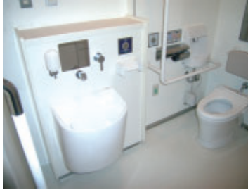
多目的トイレ
