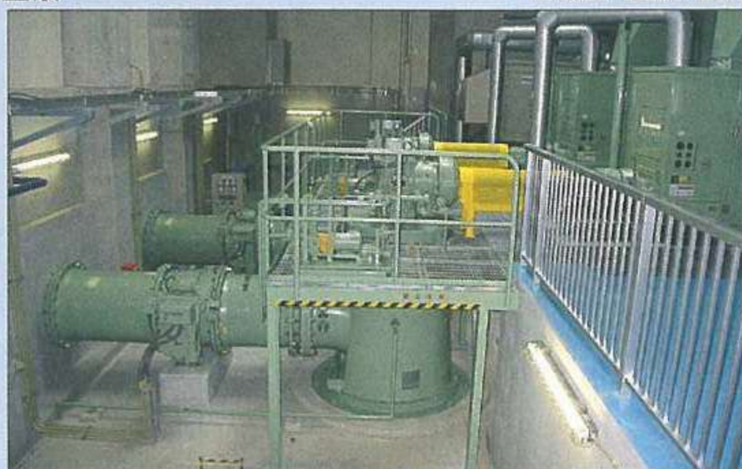
■800φ 立軸斜流ポンプ(天草市河浦町 雨水ポンプ場)
