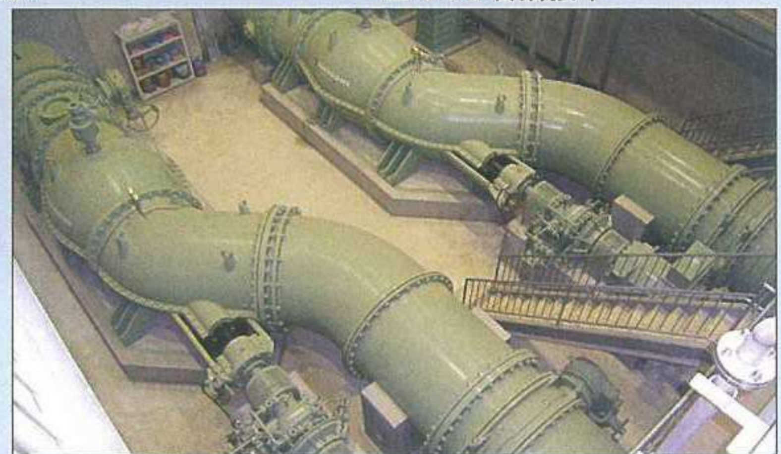
■1500φ 横軸斜流ポンプ(山鹿市藤井川北地区 排水機場)
